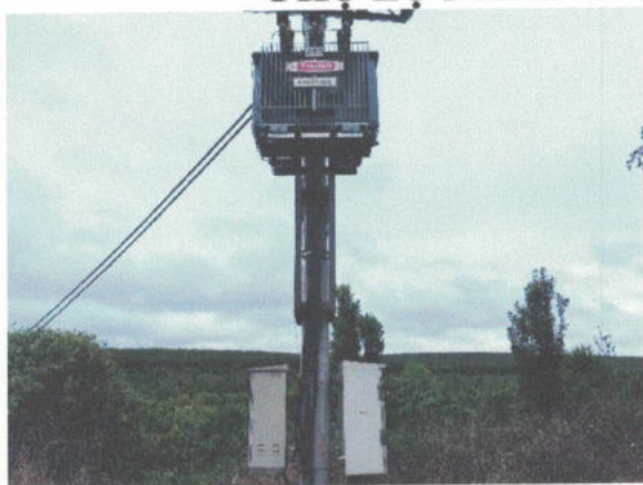
Trạm biến áp
